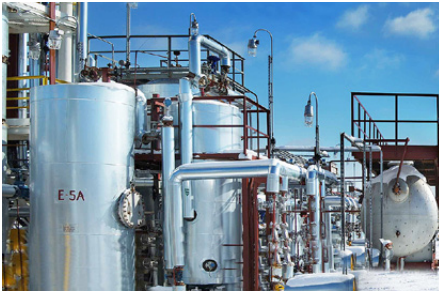
Примеры объекта нефтехимического комплекса
